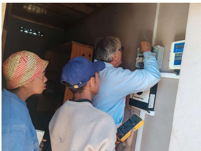
Réseau électrique d'éclairage
